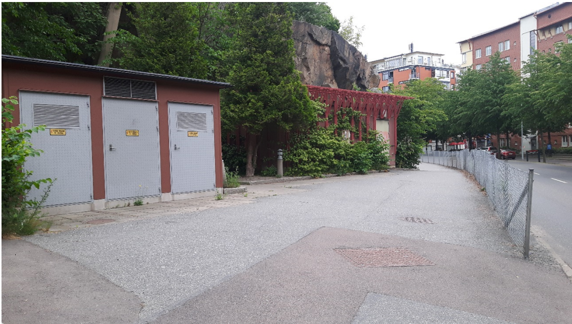
Figur 2. Byggnad för fjärrvärme (till vänster) och nätstation (till höger) i Östra Eriksbergsgatan
